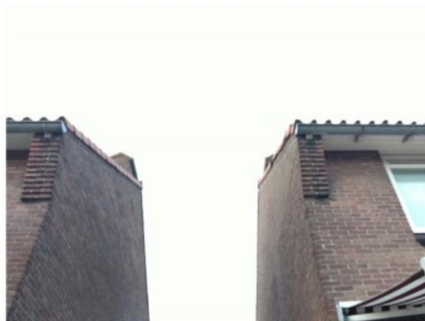
gaten in kopgevel Schielandstraat 18-20
