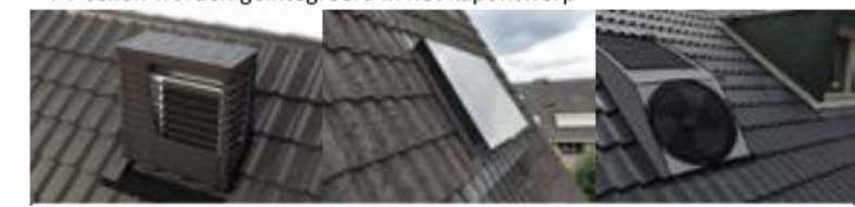
buitenunits geïntegreerd in het bouwvolume
